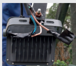
Conexões realizadas de maneira inadequada oferecendo alto risco ao produto
